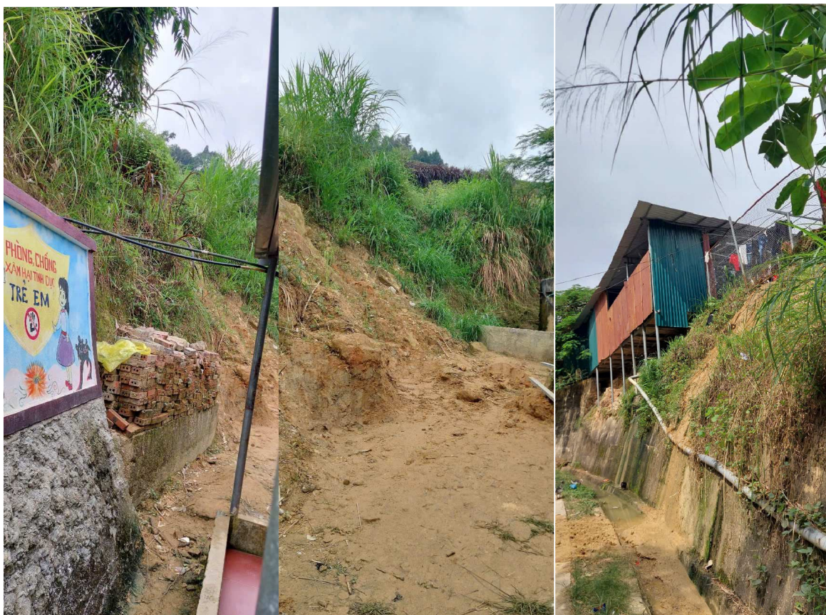
(1) Khu vực sạt lở phía sau nhà tắm và nhà vệ sinh
